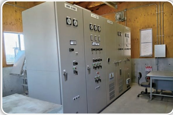
葛木揚水機場配電盤
